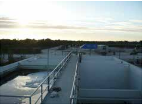
PLANTAS DE TRATAMIENTO DE AGUA
